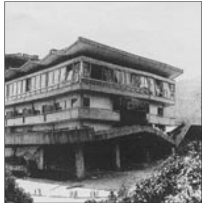
大分県中部地震で被害を受けた建物
